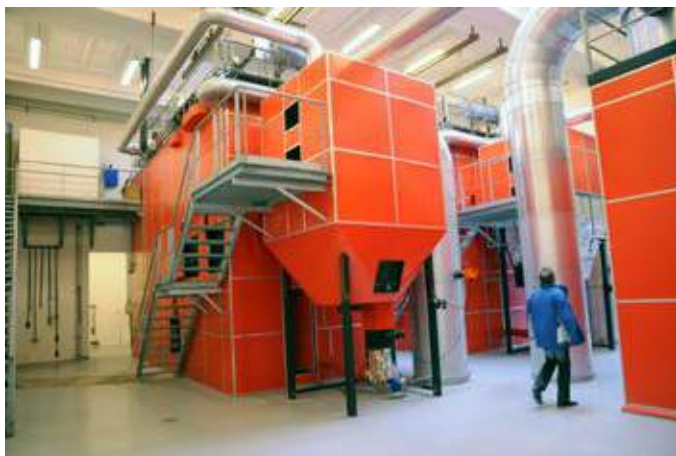
Den næste kedel på Lemvig Varmeværk bliver ikke til flis, men til el.
