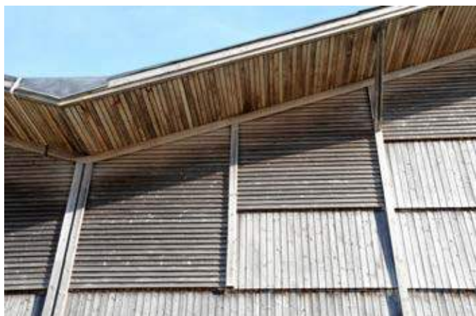
Et stort tagudhæng holder det meste regnvand væk. Billedet viser også hvordan der er brugt moduler med vandrette brædder øverst.
