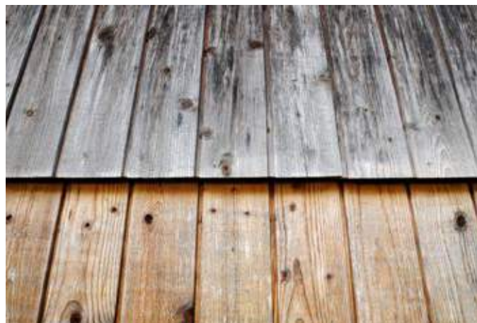
På nordsiden er lavet et forsøg med afrensning af den grå overflade. Efter tre år er træet dog blevet mørkere.
