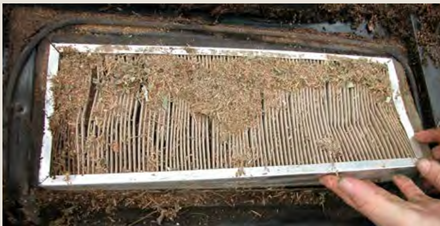
Foto 4. Først skal du vælge det rigtige filter. Dernæst skal det vedligeholdes. Det er optimalt at montere et grov-filter yderst, så fin-filteret ikke belastes unødigt.
