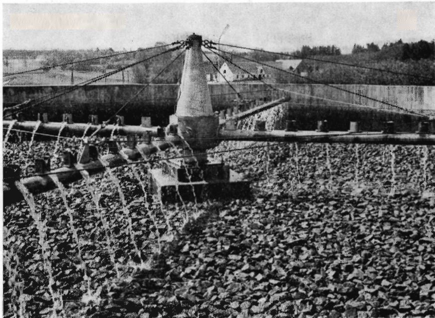
Over det biologiske filter i Møldrup fordeles det forklarede spildevand ved hjælp af en sprinkler. På filterstenene danner bakteriekulturer et slimlag, der optager og nedbryder de opløselige organiske stoffer i spildevandet.
