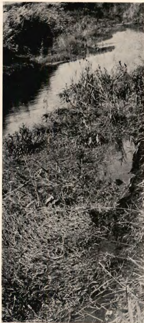
Figur 2: Skråningen skrider ud i vandløbet før stabiliseringen.
