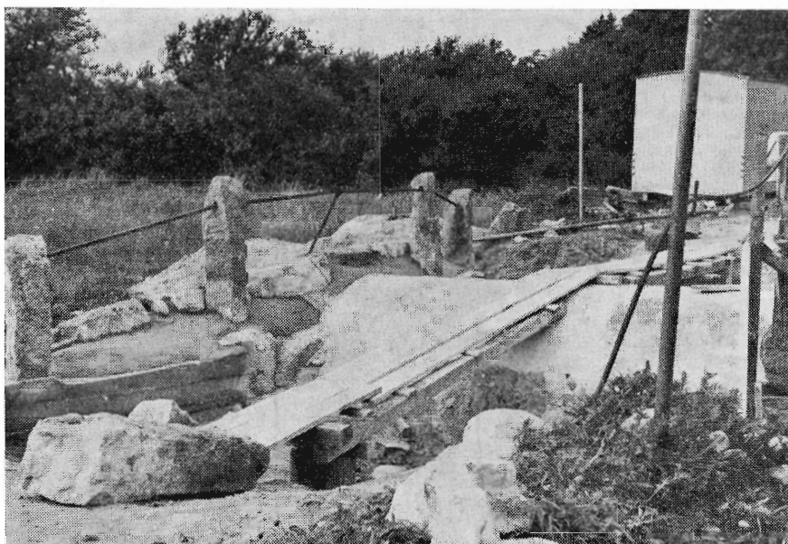
Således så Povlsbro ud efter at den var sikret ved at blive rettet op og i virkeligheden indstøbt i en kærne af cement. Man ser det gamle rækværk og midt i billedet cementstøbningen, som skal dækkes af den nye vejbane (fot. has, aug. 70).
