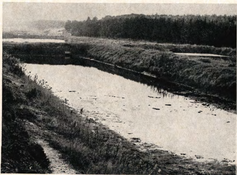
Nedsivningsanlægget ved Frederiks. I forgrunden ses et af de to bundfældningsbassiner og i baggrunden et af nedsivningsbassinerne.
