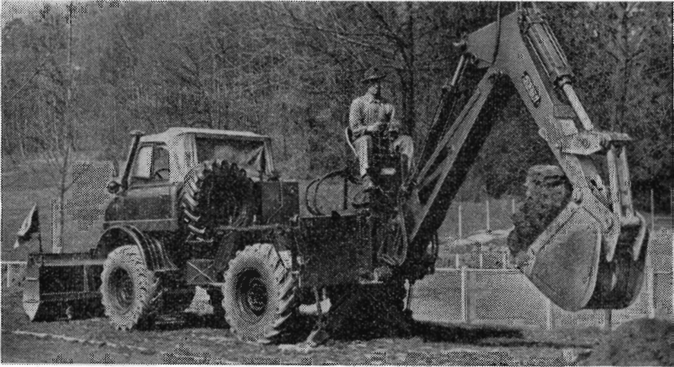
Lige gyldigt om man sidder i førerhuset eller „højt på strå“ helt bagude, har man altid en god oversigt over arbejdsområdet.
