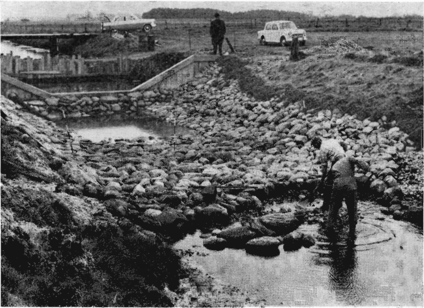
Styrt med bundsikring i Gels å i Sønderjylland.
