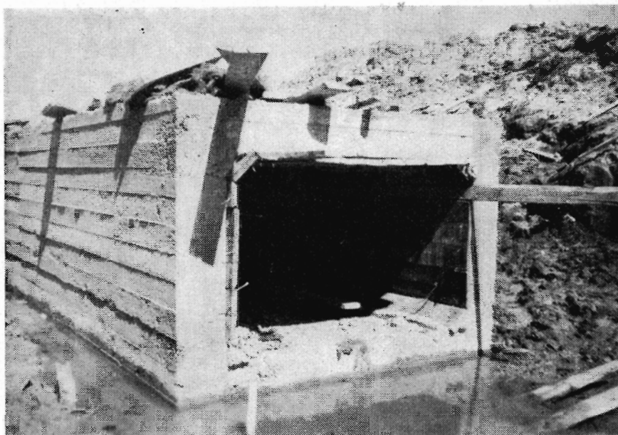
26 m langt underløb — tværmål 90 \times 130 cm — der skal føre Tagmark-kanalen under Kløv å.
