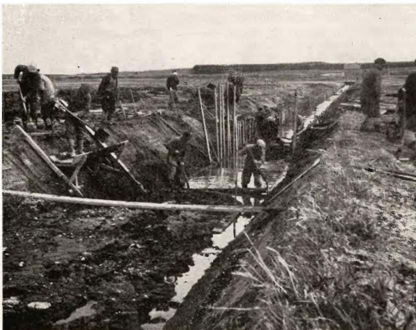
Et vanskeligt Kanalarbejde. fot. Skodshøj Trods omfattende Sikringsarbejder skyder Klæg bunden alligevel op og Siderne skrider ud.
