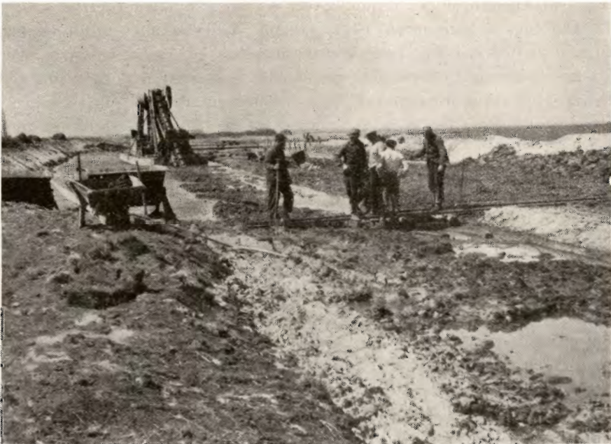
Den store Afvandingskanal ved den sydlige Del af Fiilsø fot. Skodshøj. under Udførelse.
