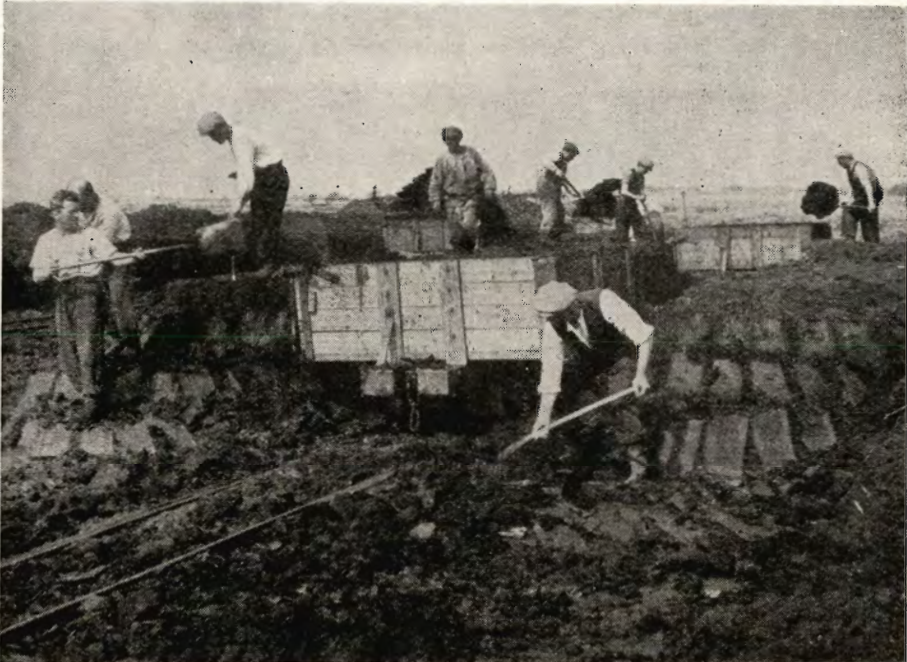
Tørvejorden afgraves og køres fra Mosen i Blaahøj op til det store Ælteværk. fot H. S.
