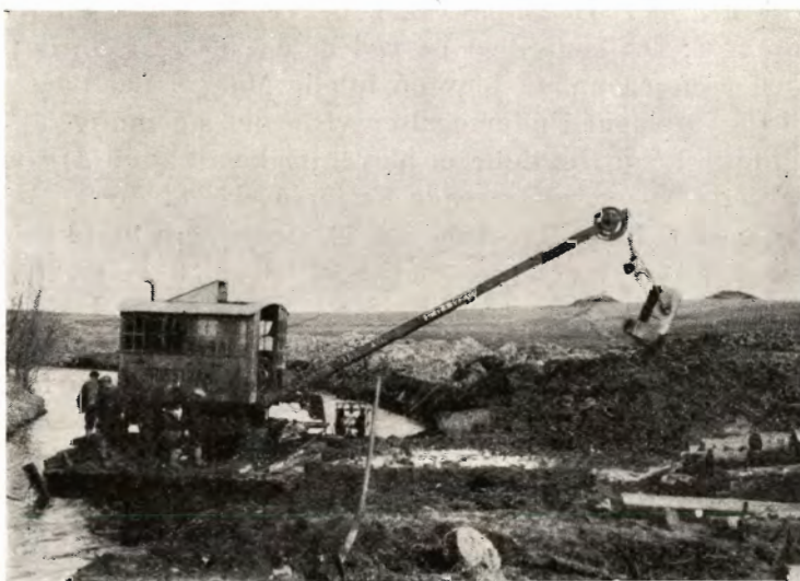
Gravemaskine i Færd med Uddybning af Hovedvandløb Nr. 5 umiddelbart ovenfor Lyngholm Bro.
