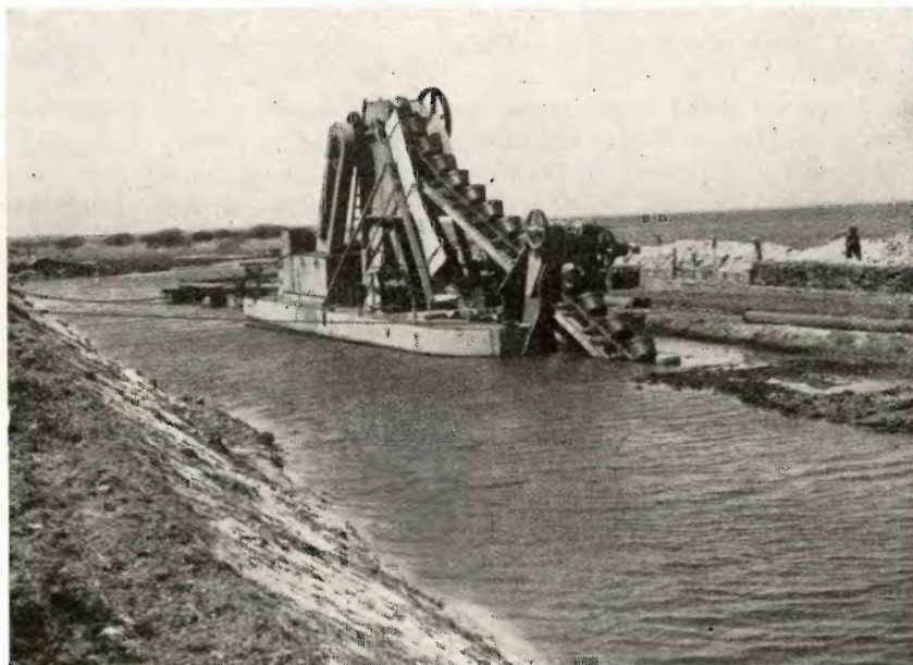
En Gravemaskine arbejder i en Hovedafvandingskanal fot. Skodshøj ved et større Landvindingsarbejde.
