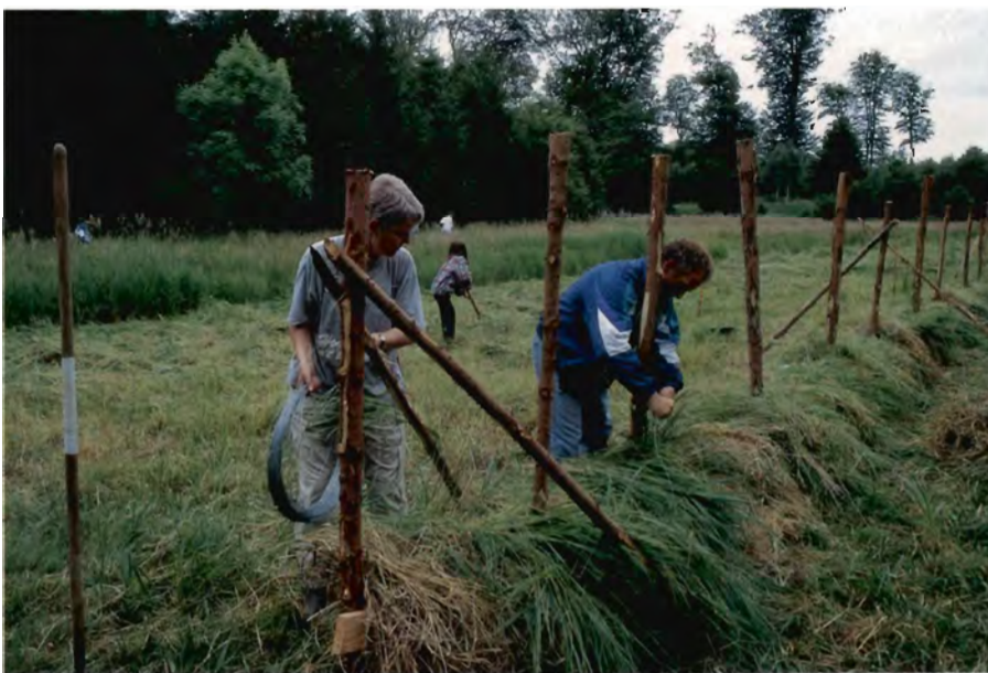
Fig. 4. Hæssene bygges op. En lang række pæle er rammet ned i engbunden, og der spændes ståltråd ud mellem dem med en god fods afstand.
