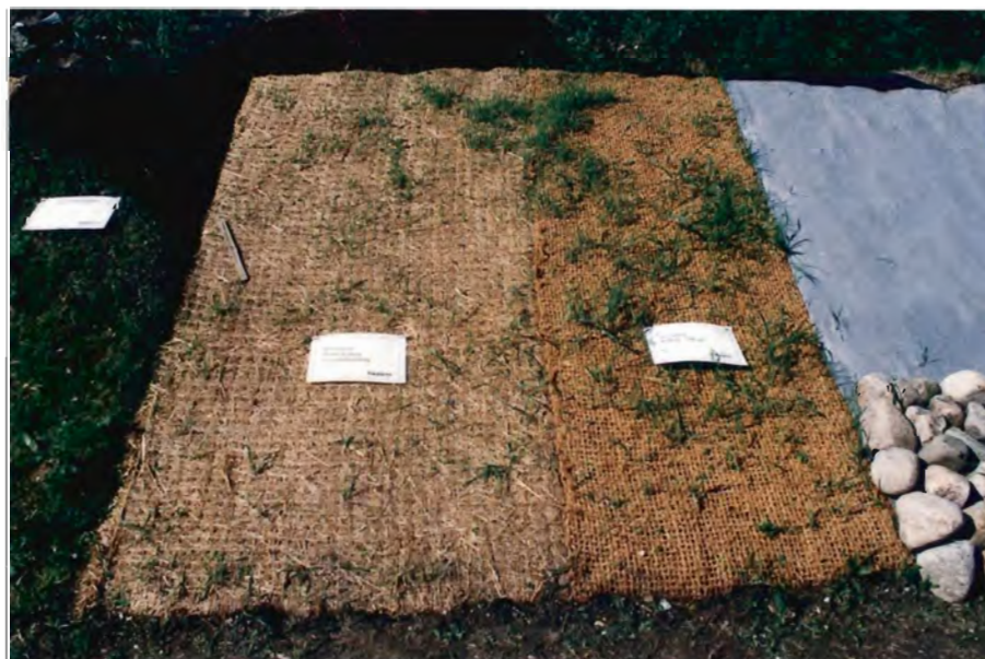
Foto 6. Måtter af plantefibre kan bruges til at stabilisere skråninger fx efter vej anlæg. Efter udlæg kan græs mv. gro igennem måtten, som nedbrydes i løbet af nogle år når planterne har fået fat. Til venstre halm/kokos med jutebinding, til højre en ren kokosmåtte. (Fra messen Have & Landskab 99).
