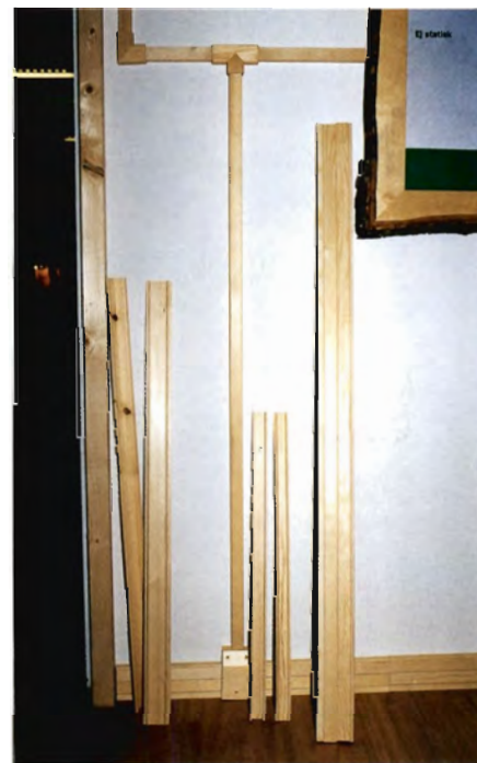
Foto 4. Kabelkanaler monteret på væggen og som fodpanel. Lænet op ad væggen står to kanaler, adskilt i over- og underdel, samt et fodpanel.
