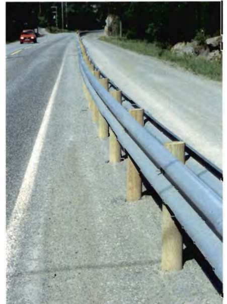
På lange strækninger af E6 mellem Oslo og Trondheim findes en type autoværn med en stålbjælke som overligger og pæle af rundtræ.
