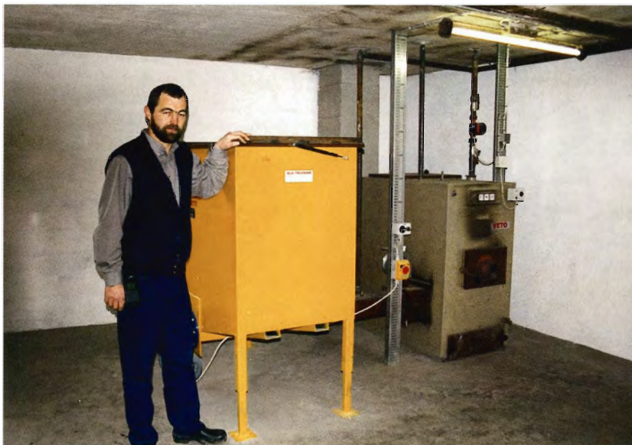
Ole West Hansen ved det fuldautomatiske varmeanlæg.
