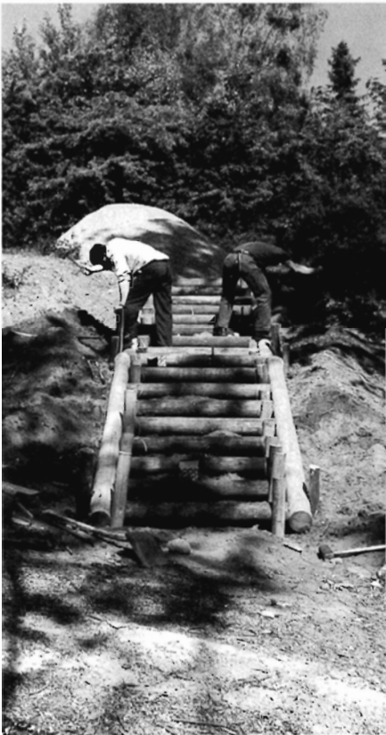
Foto 5. En anden variant er trapper lavet af runde stammer, her trykimprægnede master.
