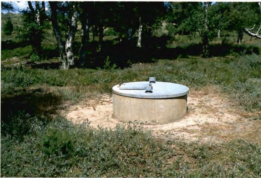
Statsskovene leverer hvert år 17 mio. m 3 drikkevand, svarende til 3,4% af det samlede forbrug. Men det økonomiske udbytte er beskedent, fordi der kan ikke opkræves afgift for det leverede vand ifølge lovgivningen. (Foto af pumpebrønd i Læsø Klitplantage).
