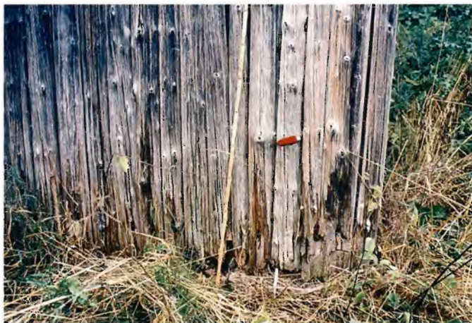
Figur 3. SØ-hjørnet set fra S. Denne råds-kade er den alvorligste, som findes i noget af skurene. Hovedårsagen hertil er, at klædning og stolpe har jordkontakt, at dette hjørne - i modsætning til SV-hjørnet - er stærkt eksponeret for sol og slagregn, og at det efter alt at dømmе har været udsat for mekaniske beskadigelser.
