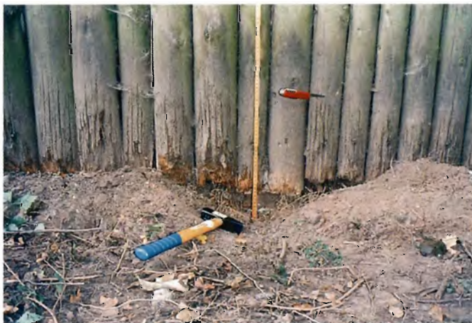
Figur 6. Del af nordside. Skønt de nederste ca. 5 cm af klædningen er dækket af jord såvel ud- som indvendigt, er råds-kaderne ubetydelige. Bemærk de hårfine tørrerevner.
