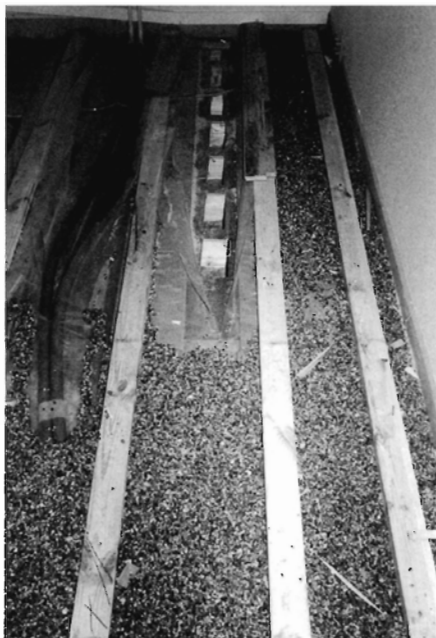
Foto 8. Der var opstået en vandskade fra en utæt radiator. Derfor er dette gulv brækket op, og man kan se opbygningen af etagedækket. I baggrunden er små felter af blændgulvet savet ud, og man kan se undersiden af etagedækket. I forgrunden ses et lag perlsten der virker som lydisolering. Bjælkerne hviler på en tynd lydisolierende måtte.
