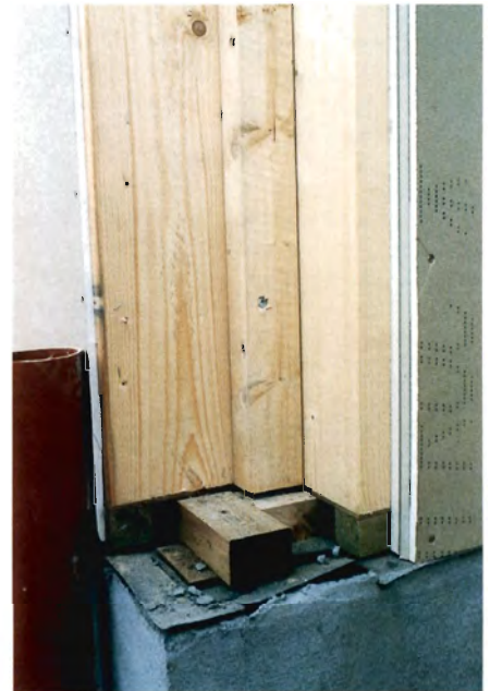
Foto 6. Risikoen for sætning gør at vægelementerne ikke hviler på en fodrem, men på en formstabil masonitplade. Der er nu kun en styrelægge til at styre huset sideværts.
