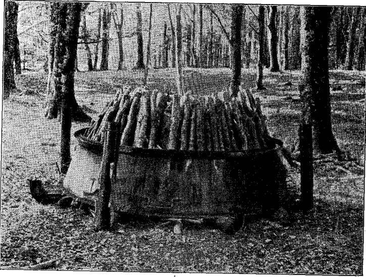
Fig. 25. Ovnens Underdel er fyldt, og de otte Rør er sat paa Plads. L'élément inférieur du four a été rempli, et les huit tuyaux mis en place.
