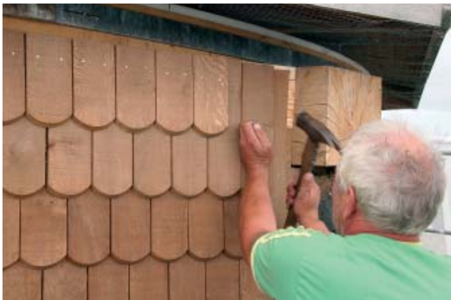
Møllebygger Jens Jørgensen er ved at montere de 16.000 træspåner af dansk eg.
