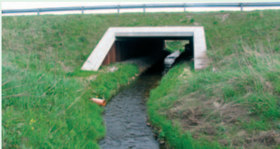
Foto 1. Rektangulær vådpassage ved Kjul Å. I rapporten anbefales, at faunaunderføringer fremover konstrueres rektangulære for at sikre så stor rummelighed som muligt specielt i forhold til, at større pattedyr også skal kunne anvende disse. Men faunapassagernes succes afhænger i høj grad af deres placering i landskabet og på dyretætheden i omgivelserne. Foto: DMU 2006.
