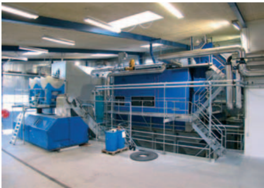
Det flisfyrede Uldum Varmeværk ved Horsens forøger kapaciteten fra 4 til 8,5 MW. (Foto: Uldum Varmeværk).
