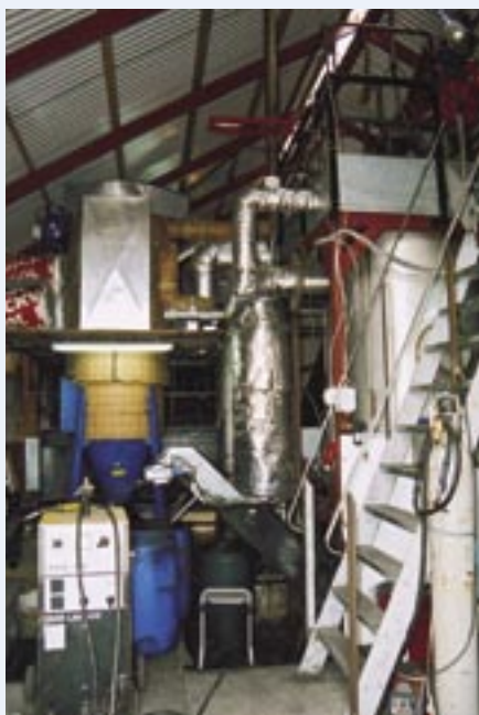
Til højre ses gasgeneratoren, til venstre posefiltret og en varmeveksler.
