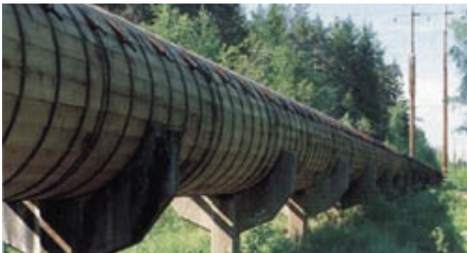
Råvandledning til Korsnäs cellulosefabrik. Længde 9 km, indvendig diameter 149 cm.
