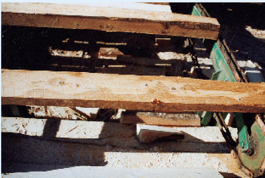
Figur 2. Honningsvampen har bredt sig ind i veddet og forårsaget rådskader. Oktober 2004.
