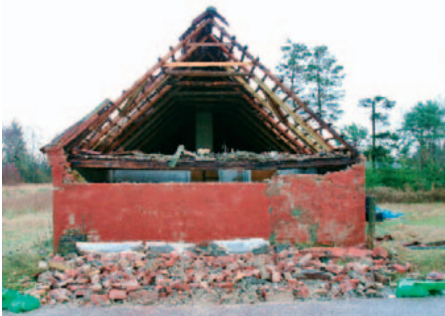
Mange steder i landet ser man huse som er skadet af stormen. Dette hus nordvest for Silkeborg blev hårdt ramt - heldigvis kom ingen til skade inde i huset. (Foto: Jesper Grønne).
